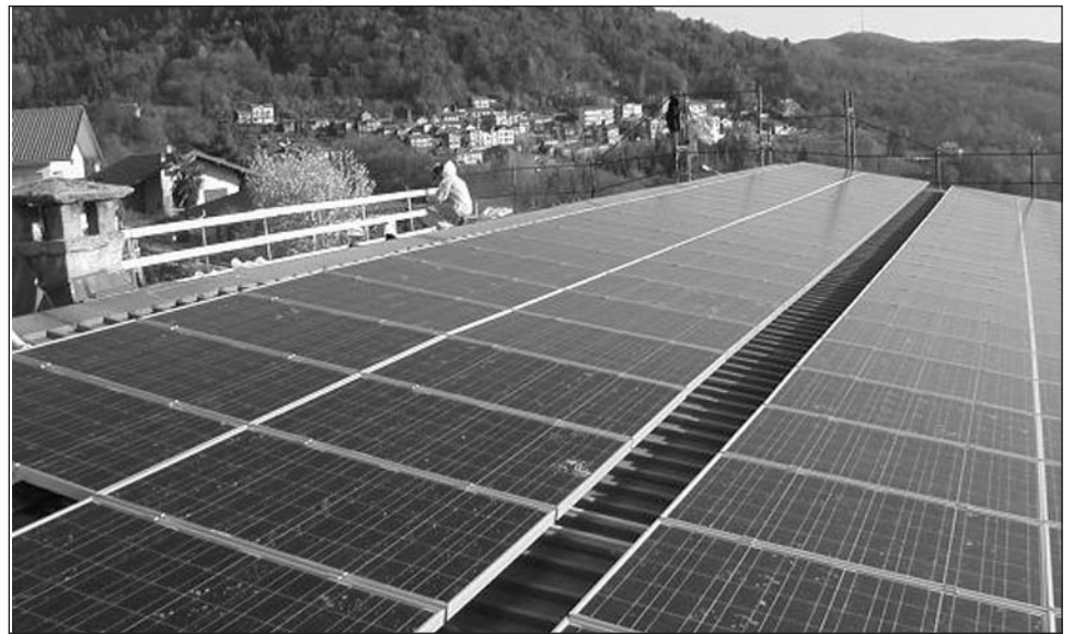
I pannelli fotovoltaici installati sull'edificio comunale
